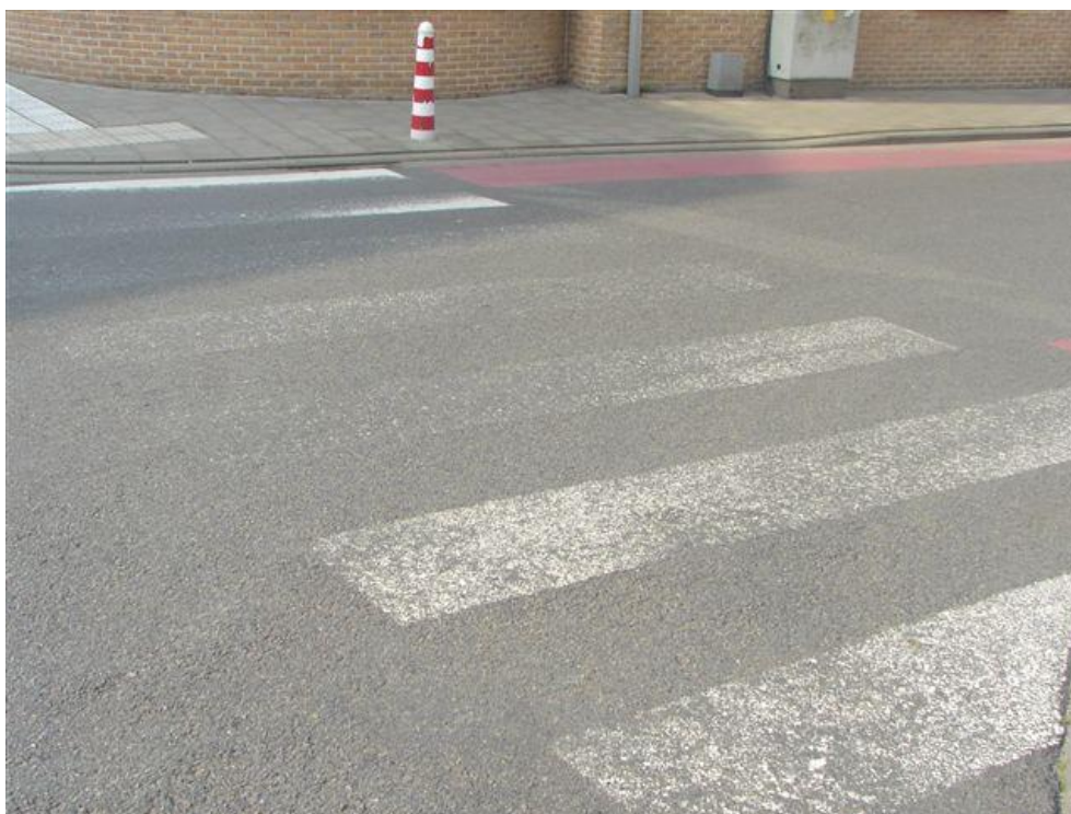
Figuur 8. Voorbeeld van een oversteekplaats waarbij het zebrapad slecht zichtbaar is.
